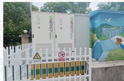
浙江台州 电气机械和器材制造业 200kW/430kWh
