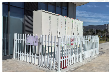
浙江温州 公共事业单位 400kW/860kWh
