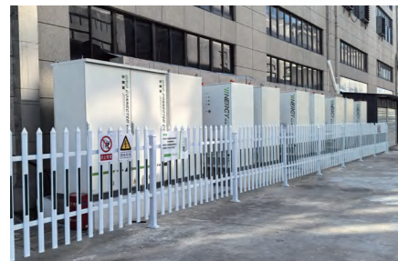
浙江台州 橡胶和塑料制品业 800kW/1720kWh
