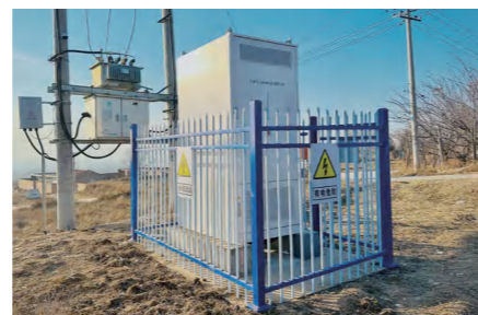
宁夏固原 台区储能 100kW/215kWh
