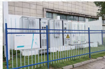
浙江温州 仪器仪表制造业 400kW/860kWh
