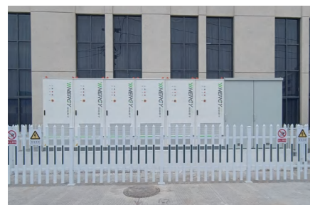
广东东莞 电缆制造业 1200kW/2580kWh
